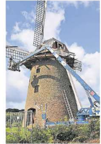
Die Mühle in Waldfeucht wird derzeit saniert. Hier war dringende Abhilfe zur Beseitigung der Schäden geboten.
