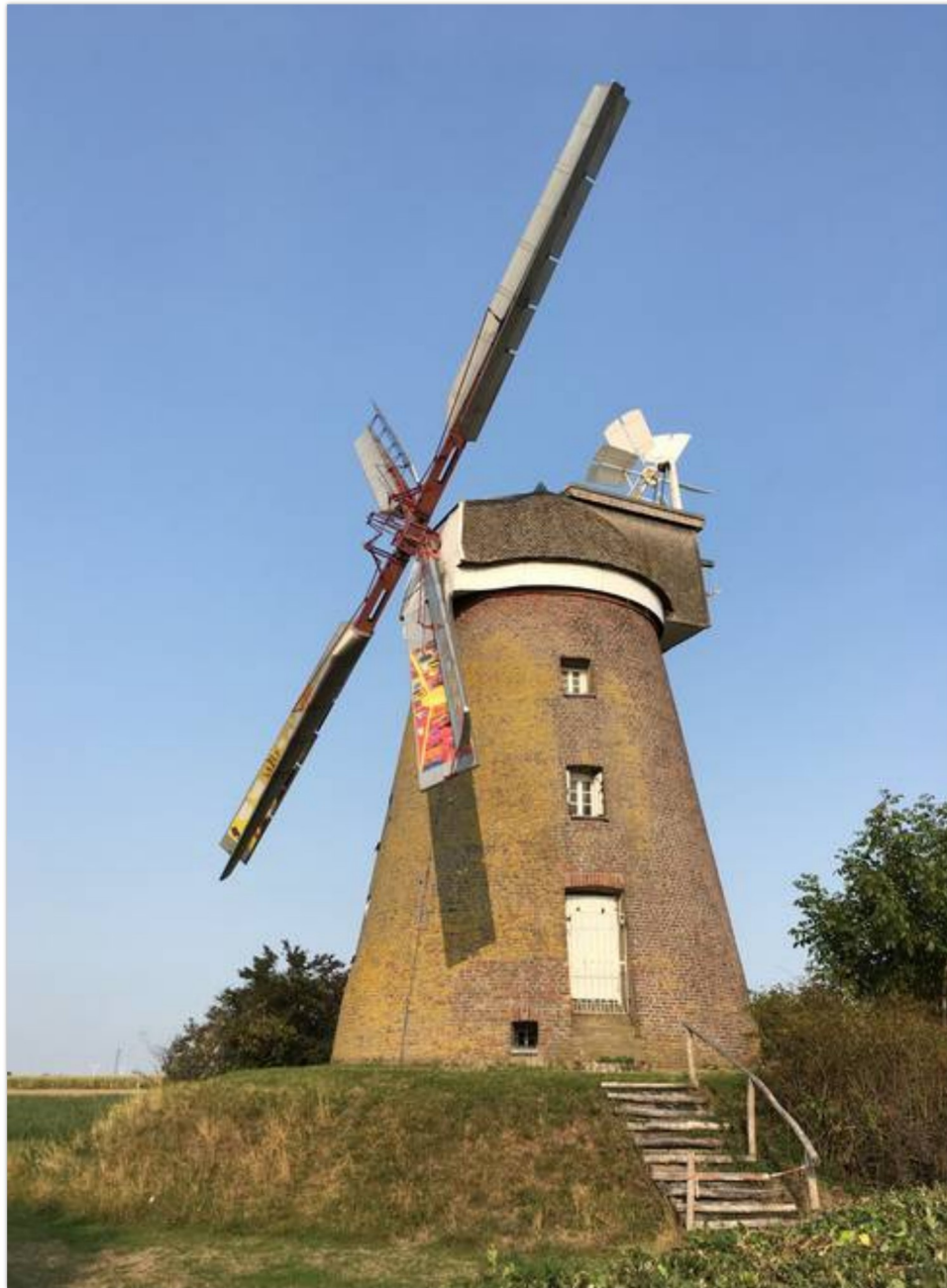
Auch hier sind Sanierungsarbeiten nötig: die Breberener Mühle. Foto: MHA/Stefan Klassen
